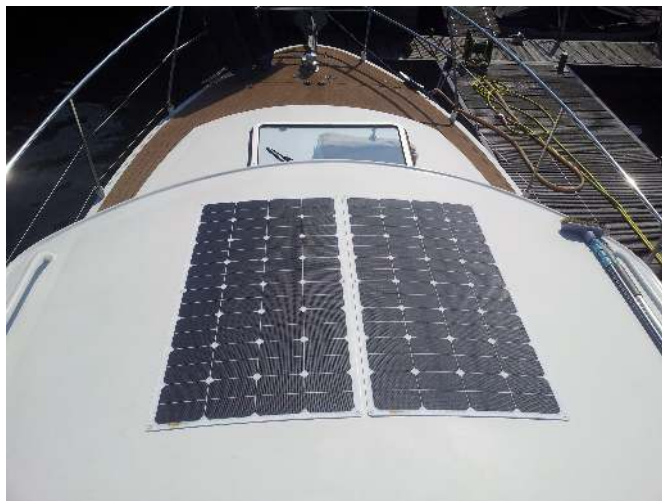
Sunbeam Flush panelen geïnstalleerd met kabel direct naar beneden doorgevoerd
